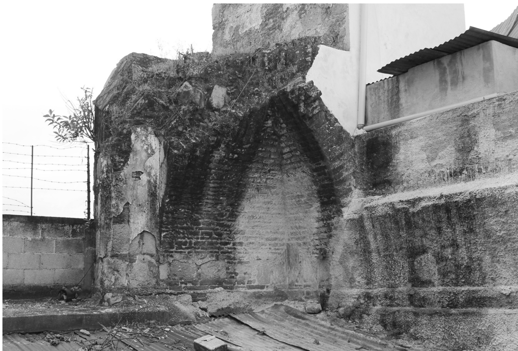
Fig.9: Impronta de arranque de bóveda y evidencias de alteración. Fuente: J. Cáceres, 2012.
