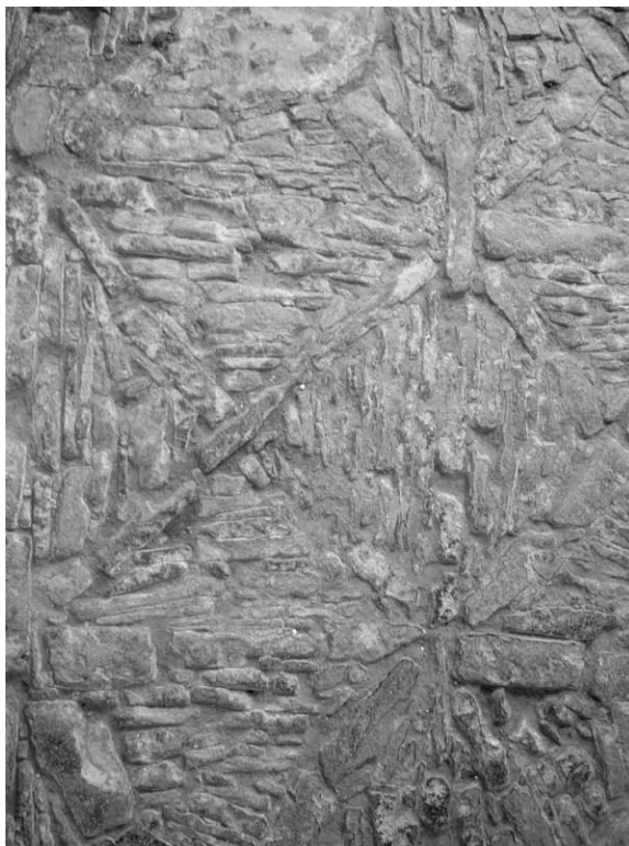
Figura 3 Ejemplo de empedrado enchinado
